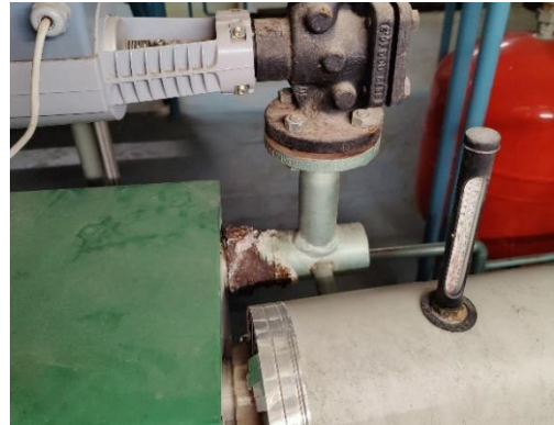
Lämmönsiirtimen putkiliitoksessa korroosiota.
