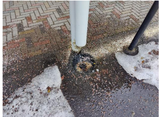
Tukossa oleva rännikaivo.
