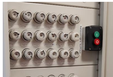
Kotitalousluokan ryhmäkeskus. Keskukseen on liitetty jälkikäteen opetuskäytössä olevien pistorasioiden hätäsammutuksen kuittaus
