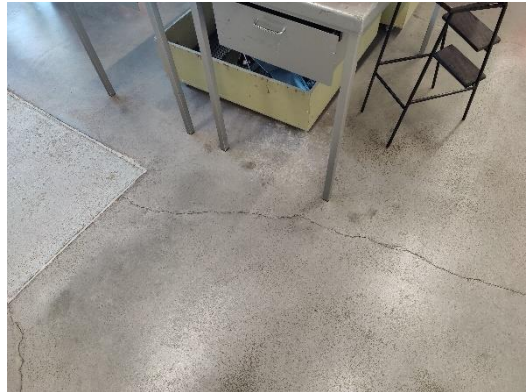
Metallipajan lattiassa havaittiin yksittäisiä halkeamia.
