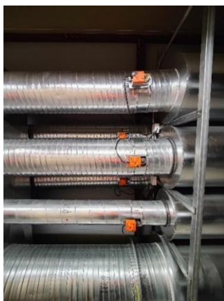
Ilmamääräsäätimiä ja toimilaitteita IV-konehuoneessa.
