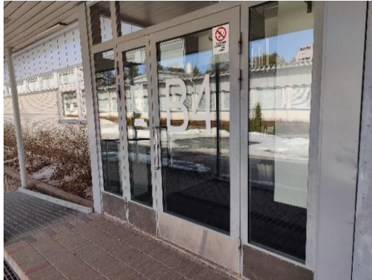
Ulko-ovet normaalissa käyttökunnossa.
