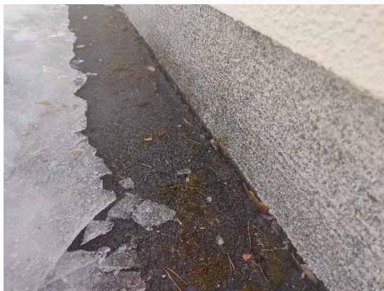
Sokkelia vasten on käytetty myöskin asfalttia. Asfaltin rajaukseen syntynyt muutaman sentin rako.
