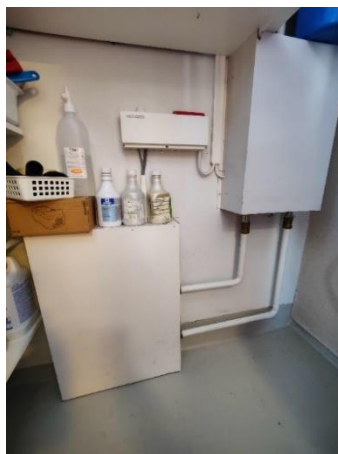
Lattialämmityksen säättöryhmä ja jakotukit sijaitsevat siivouskomerossa kotelossa.
