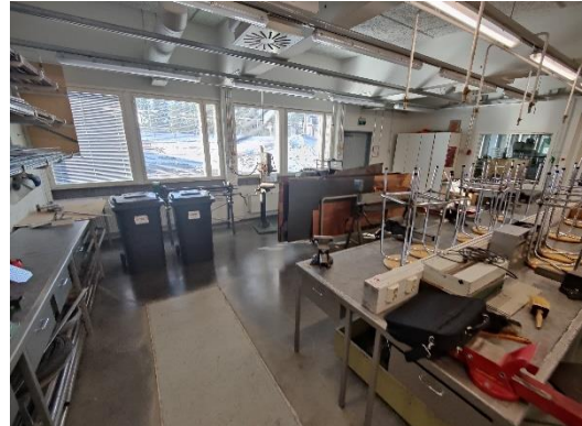
Metallipajan lattiassa havaittiin kohollaan olevia kosteuspitoisuuksia.
