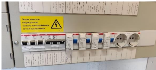
Ainoastaan yksittäinen ulkopistorasia on varustettu vikavirtasuojalla.
