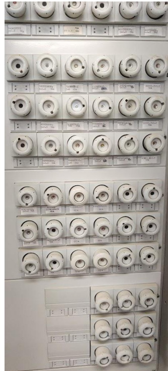
Tulppasulakkeilla varustettu ryhmäkeskus (käsi-työluokka)
