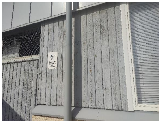
Julkisivupaneelit paikoin huoltomaalauksen tarpeessa.
