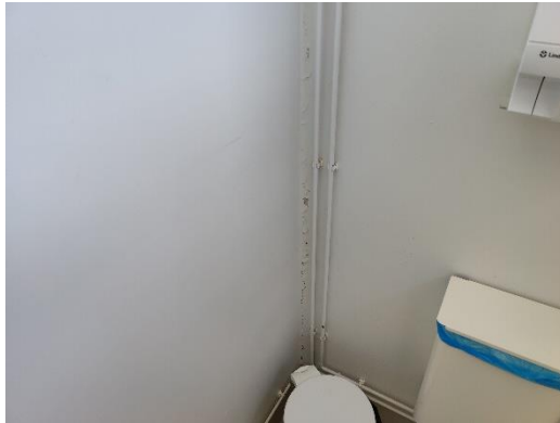
Wc-tilan nurkassa halkeama.
