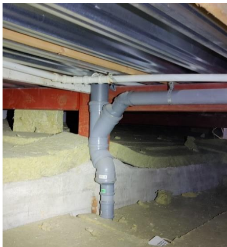
IV-konehuoneen alla välipohjassa olevia muoviviemäreitä. Viemäri supistuu virtaussuunnassa.
