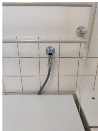
Kotitalousluokan pesukoneventtiili. Pesukoneventtiili on varustettu asianmukaisesti imusuojalla.
