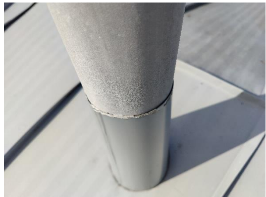
Viemärin tuuletusputken ja juurikartion rajaus ei ole tiivis.
