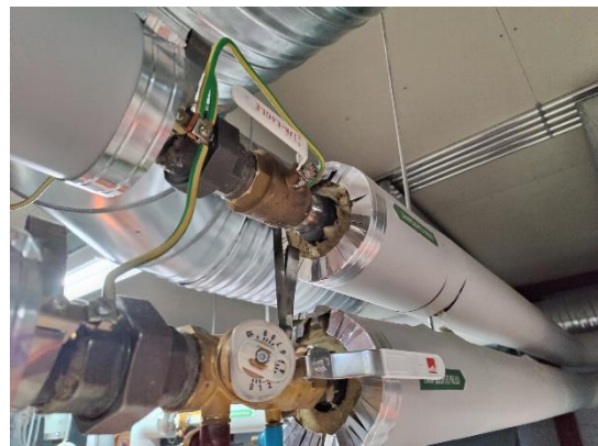
Konehuoneen putkieristeiden villakuidut näkyvillä.
