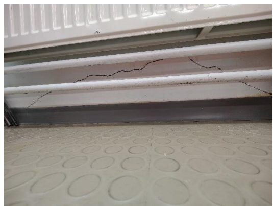
Puutyöluokan ulkoseinän halkeama.
