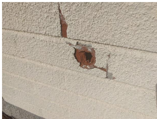
Kolhun aiheuttama tiilivaurio.
