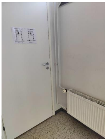
Lämmityspatteri ja patteriventtiili.
