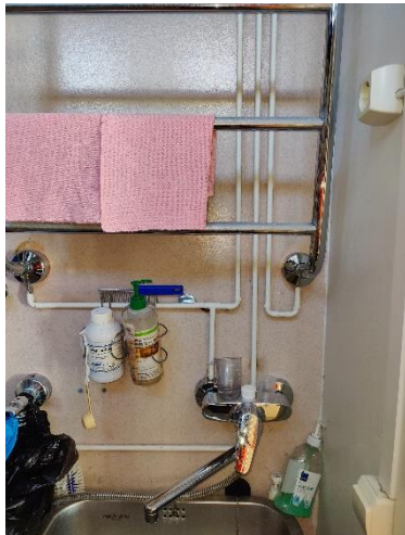
Pinta-asenteisia kuparisia käyttövesijohtoja siivouskomerossa.
