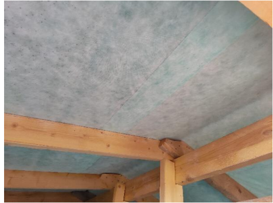
Aluskate asennettu paikoin liian kireälle. Limitykset kunnossa.
