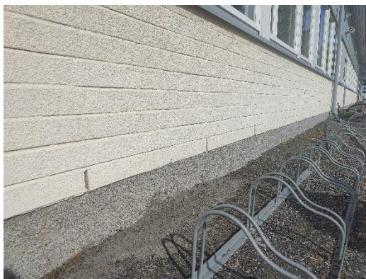
Julkisivut perussiistissä kunnossa. Alimmissa tiilivarvissa on aukijätettyjä pystysaumoja.
