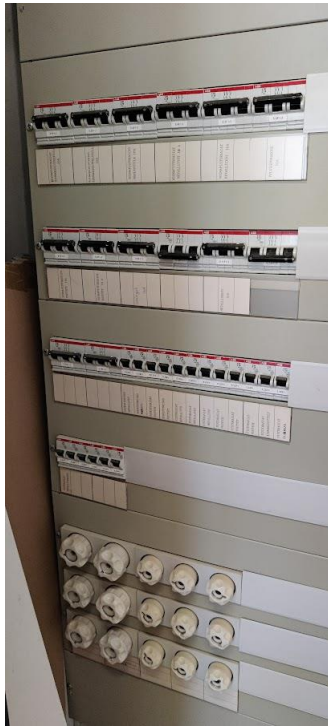
Osittain automaattijohdonsuojilla varustettu ryhmäkeskus.
