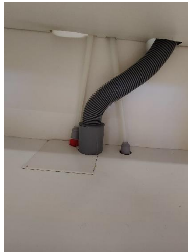
Kotitalousluokan keittiöhanan kytkentäjohdot.
