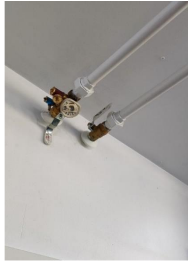
Linjasäätö- ja sulkuventtiilit.
