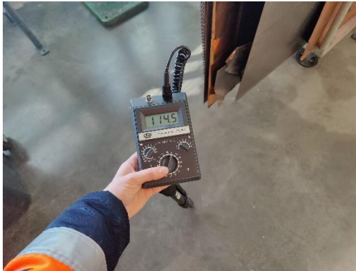
Metallipajan lattiassa havaittiin koholla olevia kosteuspitoisuuksia.
