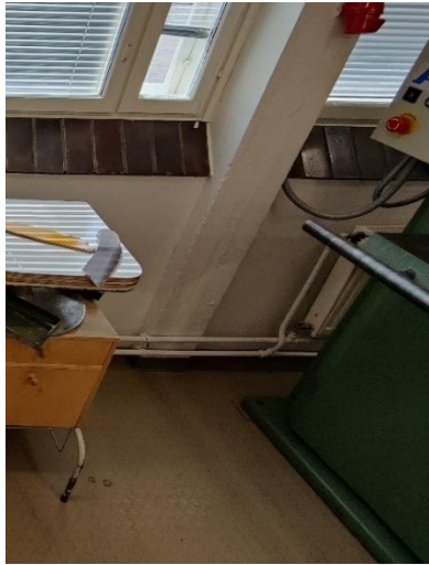
Lämmityspatterin kytkentä- ja jakojohdoja kierrelitöksiin.
