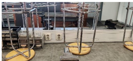
Käsityöluokan pistorasiat kuluneita, puuttuu vikavirtasuojaus.
