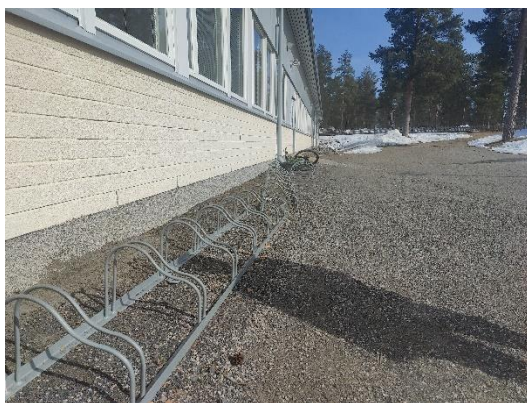
Patolevyn yläreunalista jätetty maanpinnan alapuolelle.
