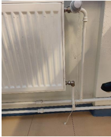
Lämmityspatterin kytkentä- ja jakojohdoja kierre- ja hitsausliitoksien.
