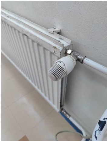
Lämmityspatteri ja patteriventtiili luokkahuoneessa.
