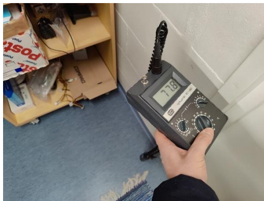
Kellaritilan valvontakeskuksen lattianrajasta havaittiin hyvin lievää koholla olevaa kosteutta.
