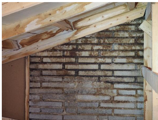
Vanhoja kosteusjälkiä piipun seinämällä.
