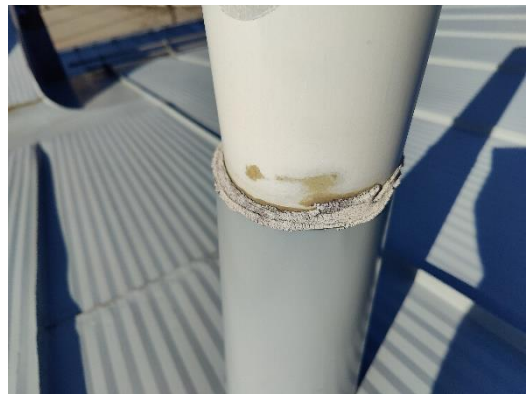
Juurikartioiden tiivistemassaukset rakoilevat.
