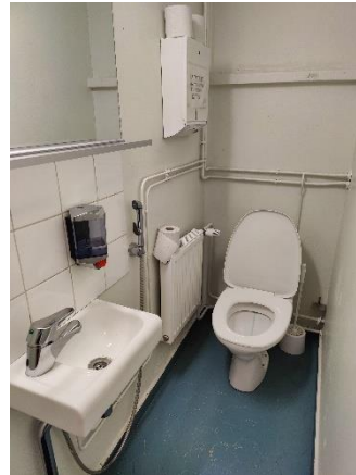
Pinta-asenteisia käyttövesijohtoja WC-tilassa.
