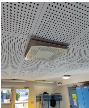
Käytävän tuloilmalaite on vääntynyt.
