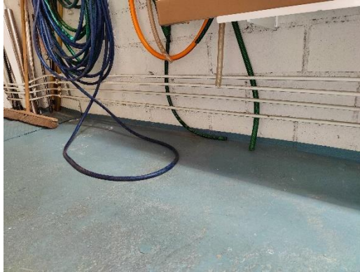
Pinta-asenteisissä käyttövesijohtojen kannakoinnissa on puutteita.
