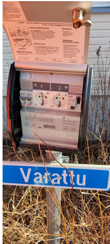
Autolämmityspistorasiat on hyvässä kunnossa.
