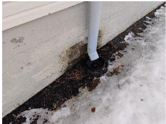
sadevedet roiskuvat sokkelipinnoille.
