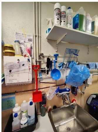
Käyttövesijohtojen käyttäminen tavaroiden säilytykseen/ripustamiseen aiheuttaa putkistolle ulkoista rasitusta.
