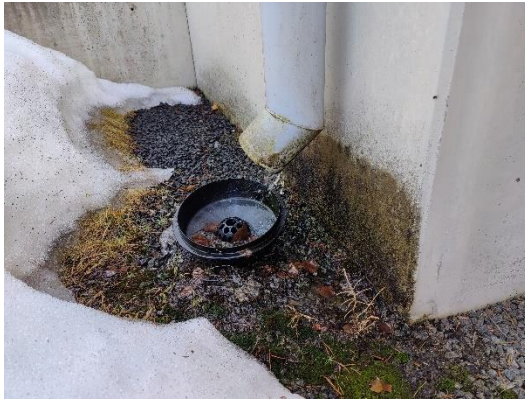
Syökysyrtöltä aiheutuu kosteusrasitusta sokkelipinnoille.
