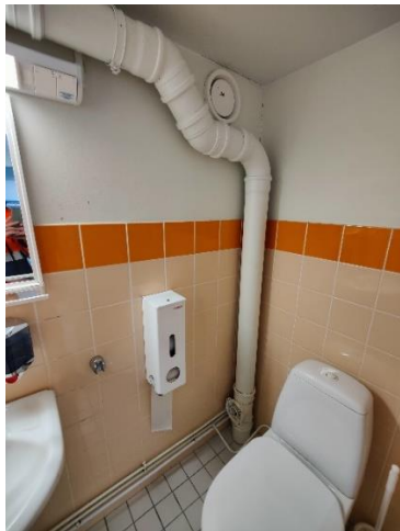
Pinta-asenteinen muoviviemäri. Puhdistusluukku lattian rajassa.
