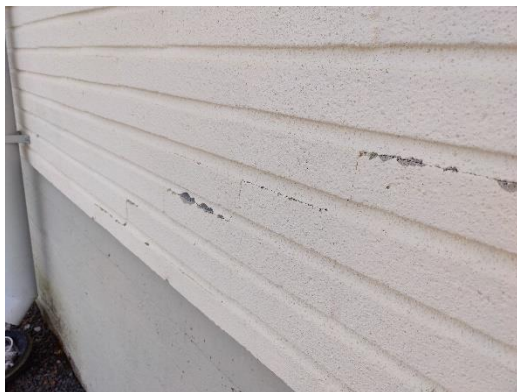
Yksittäinen halkeama tiilipinnalla.
