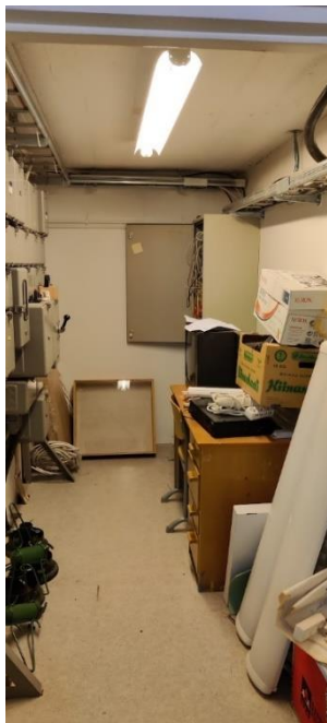
RK 1 tilassa ylimääräistä palokuormaa
