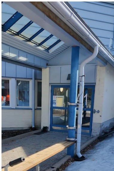
Sisäänkäynnin yhteydessä olevat rännien sulanpitolämmitykset tulisi uusida.
