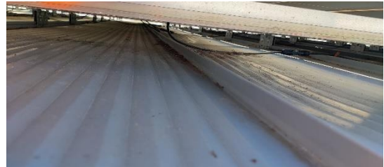
Aurinkopaneelien johtojen kiinnitys tarkastettava ja korjattava.
