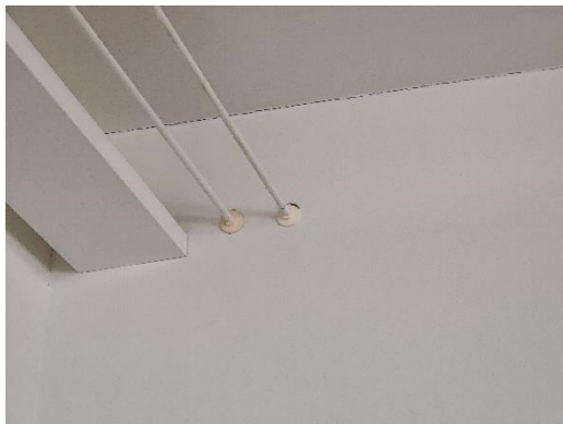
Yksittäisiä tiivistämättömiä läpivientejä eri tiloissa.
