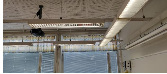
Luokkien valaistus, loisteputkivalaisinrungot, joihin osittain vaihdettu LED-putkia.
