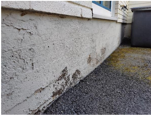
Osa sokkelipinnoista huoltomaalauksen tarpeessa.
