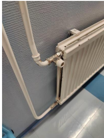
Käytävän patterin käsiasäätöpyörä on rikki.
