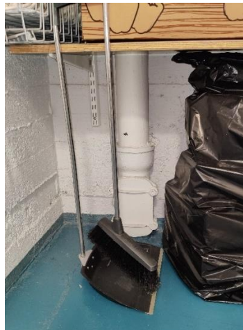
Pinta-asenteinen valurautaviemäri. Puhdistusluukku lattian rajassa.
