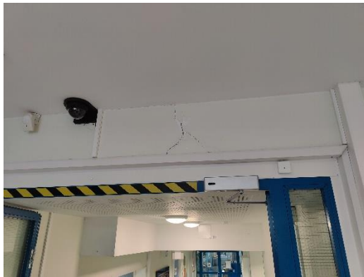
Halkeama käytävän 102 ja 143 välisen oven kohdalla.
