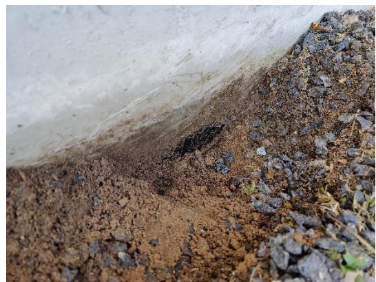
Patolevy jätetty maanpinnan alapuolelle ilman yläreunalistoa.
