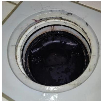
Lattiakaivot ovat muovikaivoja.
