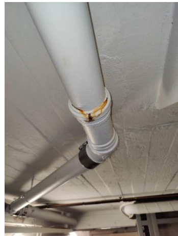
Kellarinkatossa kulkevassa viemärissä vuotojälkiä.
