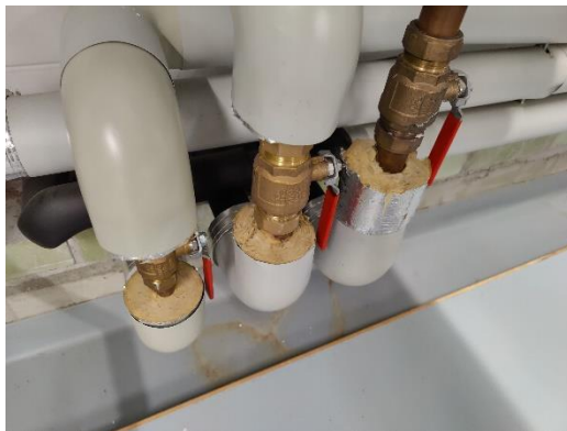
IV-konehuoneen putkieristeiden päät avonaiset.
