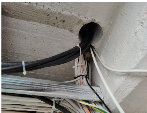
Kellarin tiivistämätön läpivienti.
