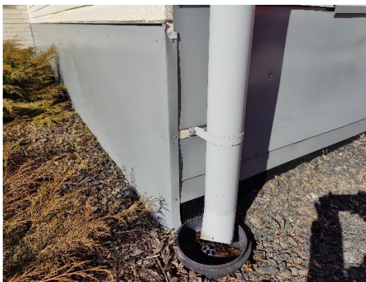
Sisäpihalla vanha betonisokkeli on pellitetty kauttaaltaan. Patolevystä saatiin näköhavainto.
