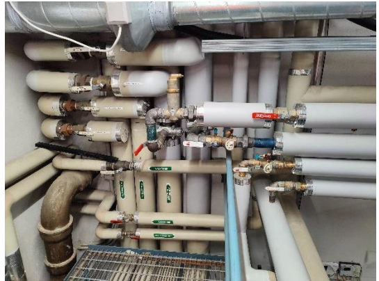
Lämmitysverkoston putkia ja venttiileitä lämmönjakuhuoneessa.
