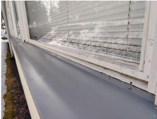
Vanhojen ikkunoita vesipelleissä tiiveyspuutteita.
