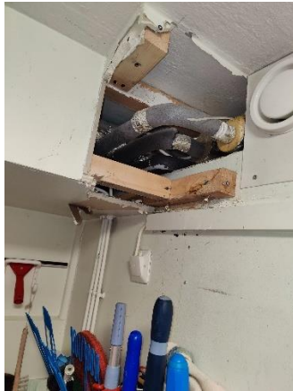
Piilossa kulkevat käyttövesijohdot on eristetty mineraalivillakouruilla ja solumuovieristeellä.
