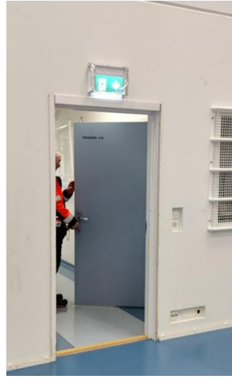
Poistumistievalaisimia, joista osa on uusittu.
