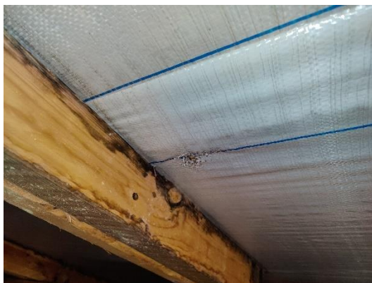
Aluskatteessa reikä, sekä yläpaarteissa vanhoja kosteusjälkiä.
