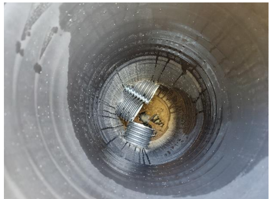
Tarkastuskaivolta tarkasteltuna järjestelmä vaikutti toimintakuntoiselta.
