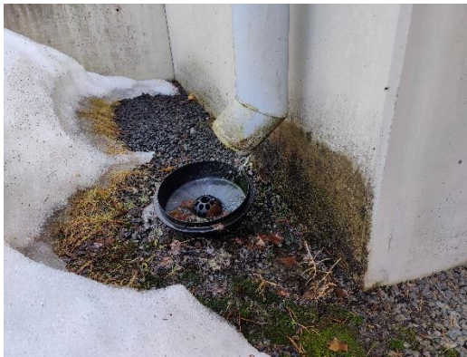
sadevedet roiskuvat sokkelipinnoille.
