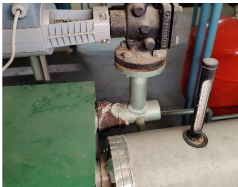
Lämmösiirtimen putkiliitoksessa korroosiota.
