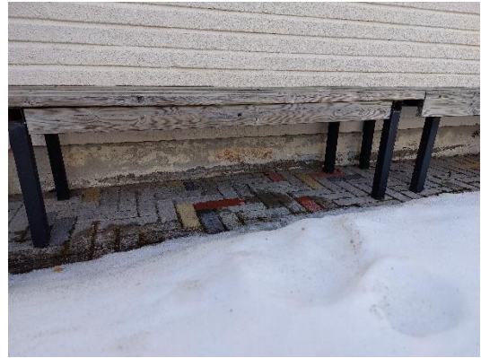
Osa sokkelipinnoista huoltomaalauksen tarpeessa.
