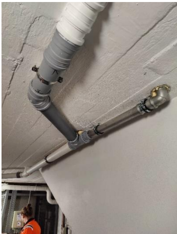
Muoviviemäriin liitetty rst-viemäriin kallistus väärään suuntaan.
