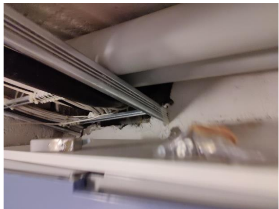
Kellarin tiivistämätön läpivienti.
