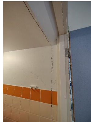
Halkeama käytävällä 139, WC 2.
