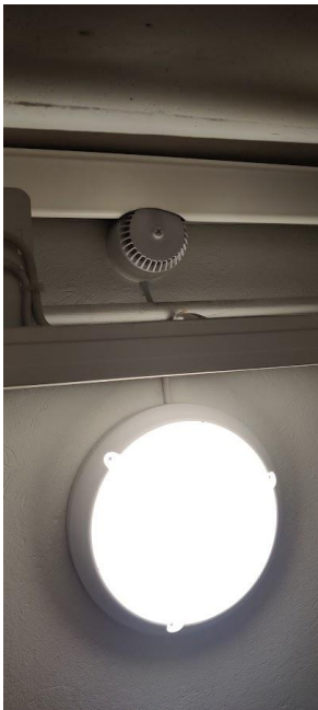
Paloilmaisin kellarin seinällä, osittain peitetty koteloasennusten yhteydessä, korjattava.
