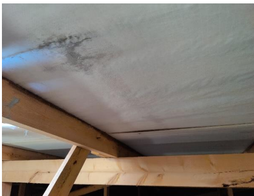
Aluskatteen päällä kosteutta, yläpaarre märkänä.
